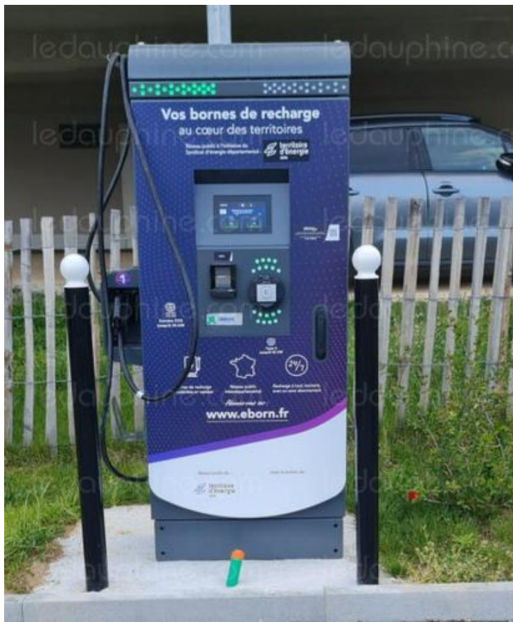
La borne est installée sur le parking du verger des écoliers. Photo Mairie de Luzinay
